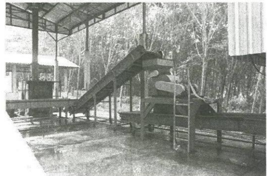
เครื่องจักรลำเลียงขยะ : โรงงานกำจัดขยะ เกาะยาวน้อย จ.พังงา
